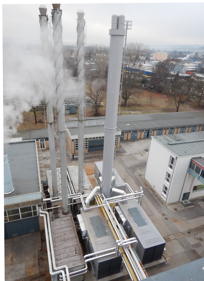
Heißwasserkessel in der Fernwärme-Zentrale Graz
