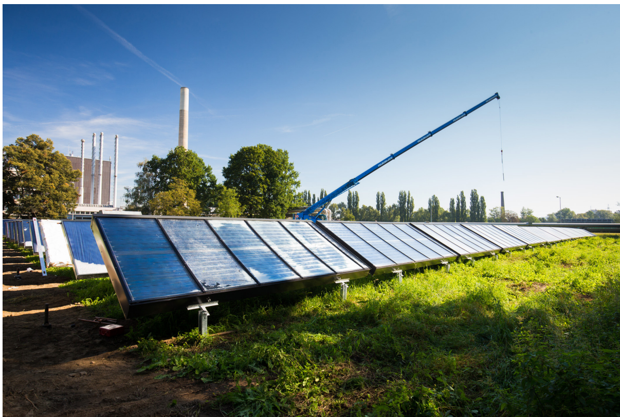
Solaranlage am Areal der Fernwärme-Zentrale Graz
