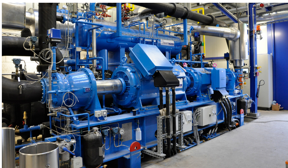
Wärmepumpe in der Marienhütte Graz
